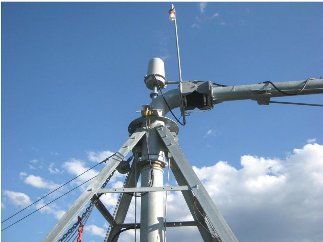
Рис. 3 Загальний вигляд верхньої частини силового візка (шарнірна муфта, струмоперехід)
