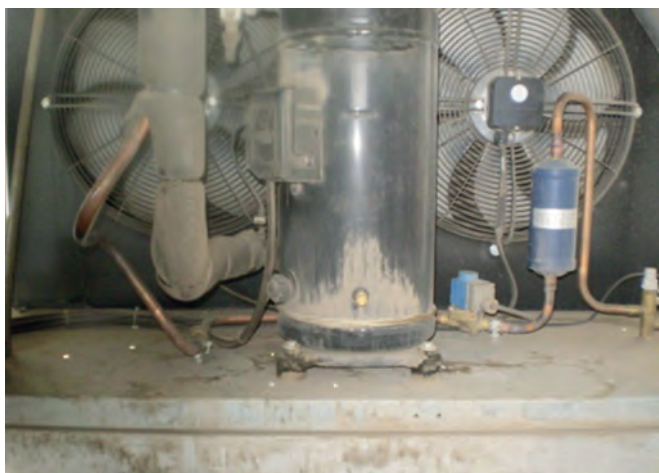
Рисунк 3 – Загальний вигляд холодильного агрегата
