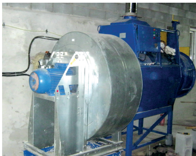
Рисунок 15 – Загальний вигляд теплогенератора у складі з вентилятором
