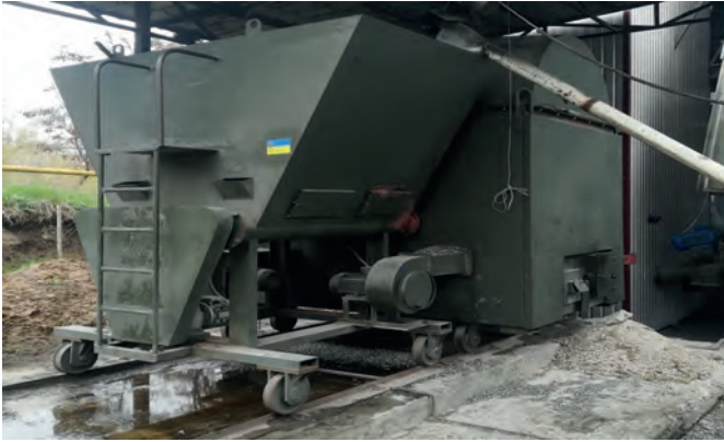
Рис. 11 — Установка попереднього спалювання ТПГ-1250-2500
