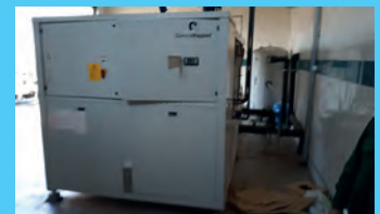
Загальний вигляд чиллера з рекуператором тепла
